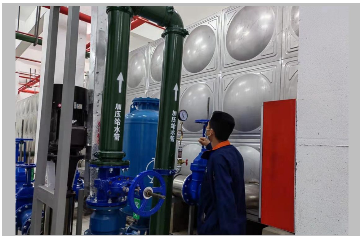
在北校区进行水泵巡检
